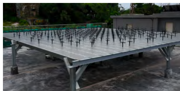
▲協助氣象局建置完成東沙島剖風儀 1 座，增加颱風預警能力。
